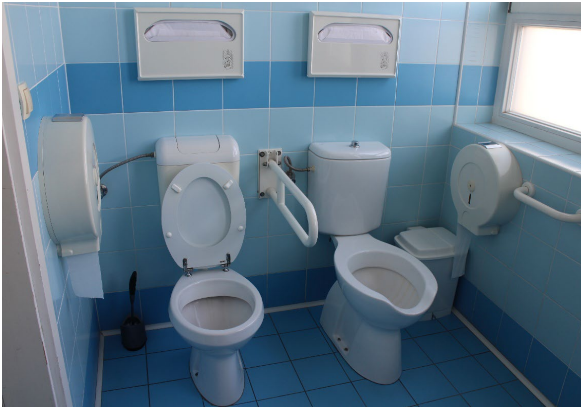
Neprimerna "invalidska" oprema.
